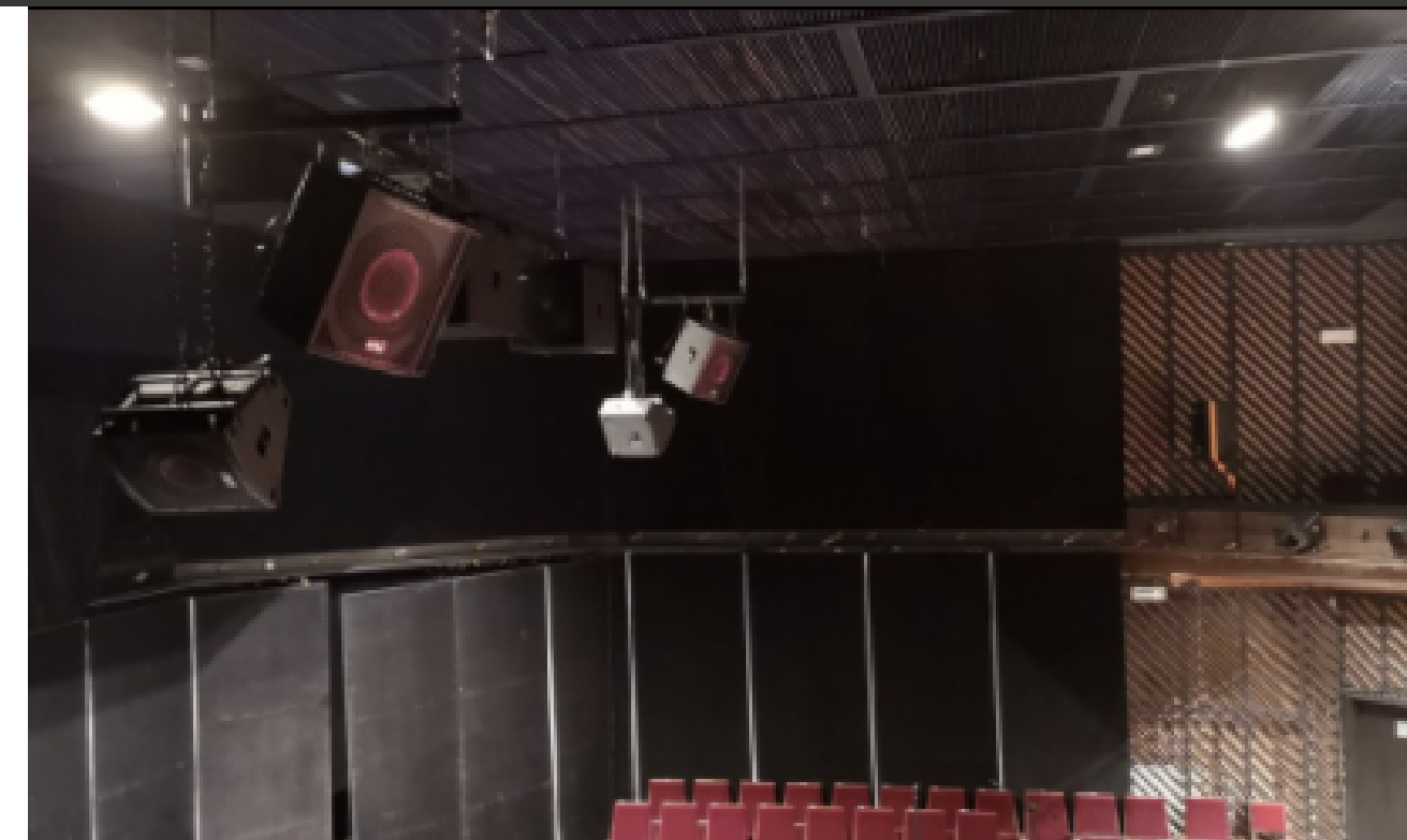
SCENA TEATRU Z INSTALACJĄ DŹWIĘKOWĄ NAW TRUE POINT SOURCE - KIELECKIE CENTRUM KULTURY
